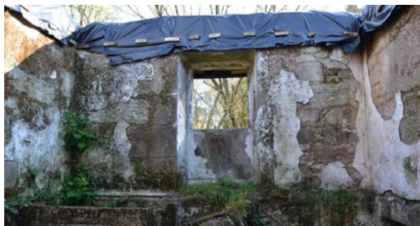
8. Desprendimiento de revocos
