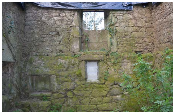
9. Deslavado de juntas y aparición de organismos vegetales
