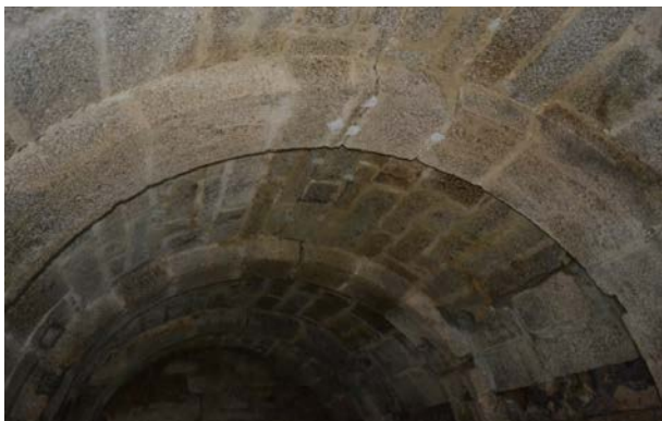
7. Filtraciones en la sala de molienda, y grieta de clave
