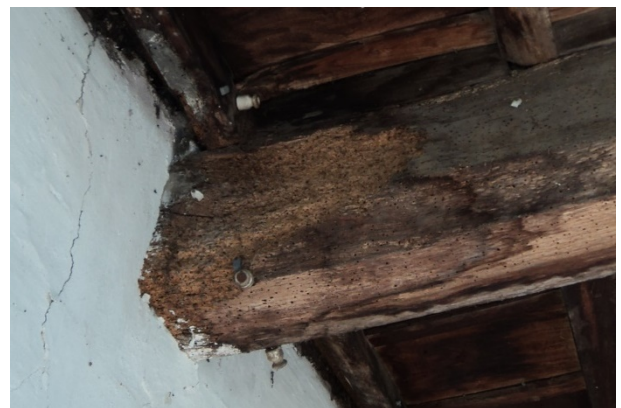
9. Apoyo de viga con ataque de carcoma
