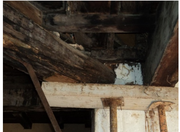
8. Apoyo de viga con pudrición parda
