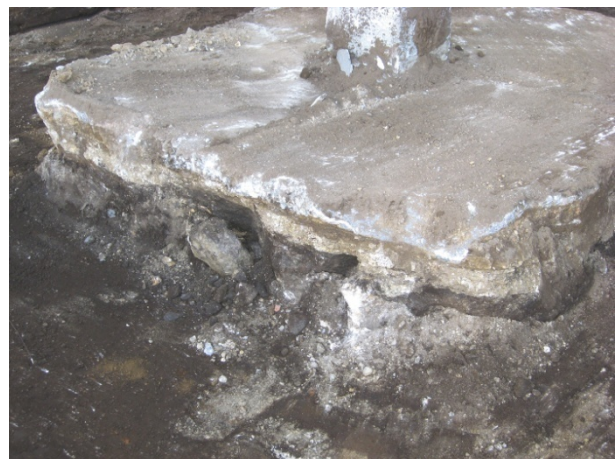
8. Estado previo de las zapatas aisladas.
