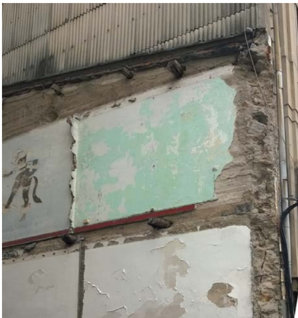
5. Detalle de apoyo de viga de madera en muro de hormigón en masa
