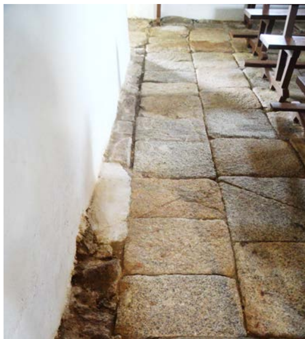
8. Vestigios de un anterior cerramiento de mayor grosor bajo los muros laterales
